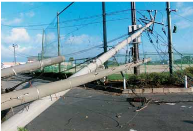
倒壊した電柱
